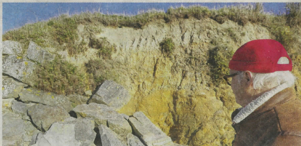
Fabrice Pervez devant l'effondrement d'un enrochement sur la baie du Cabonnais BE
